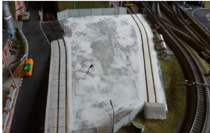
Im nächsten Arbeitsschritt wurde der komplette Platz verspachtelt. Das Pflaster sollte stellenweise aber weiterhin erkennbar bleiben.
